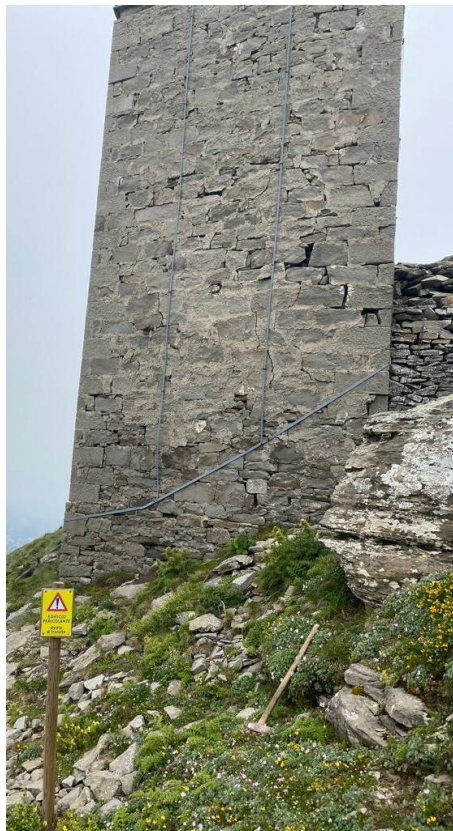
Fig. 4: la cartellonistica di avvertimento per rischio crollo è stata posta in corrispondenza dei possibili punti di transito o sosta degli escursionisti.
