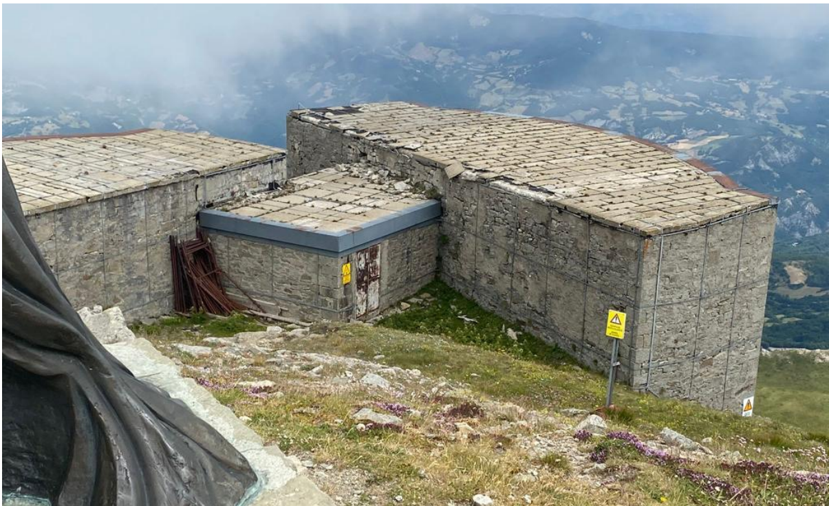
Fig. 2: foto di una porzione della parte sommitale della infrastruttura porta antenne Venda-Settepani, in particolare l'unità a Nord è quasi totalmente lesionata e le porzioni di copertura e muratura staccate dagli agenti atmosferici, in alcuni casi precipitate o a rischio crollo.
