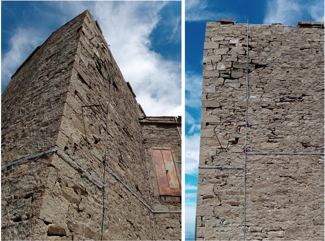
Fig. 5 e 6: particolari delle fratture murali sullo spigolo Ovest dell'infrastruttura porta antenne Venda (versante verso Nord della zona segnalata); l'infrastruttura Venda è a concreto rischio crollo, essendo direttamente esposta al versante meteorologicamente più sfidante nel periodo invernale, con l'introduzione nei muri di acqua sopralfusa che poi gelando fa esplodere la malta tra i conci.
