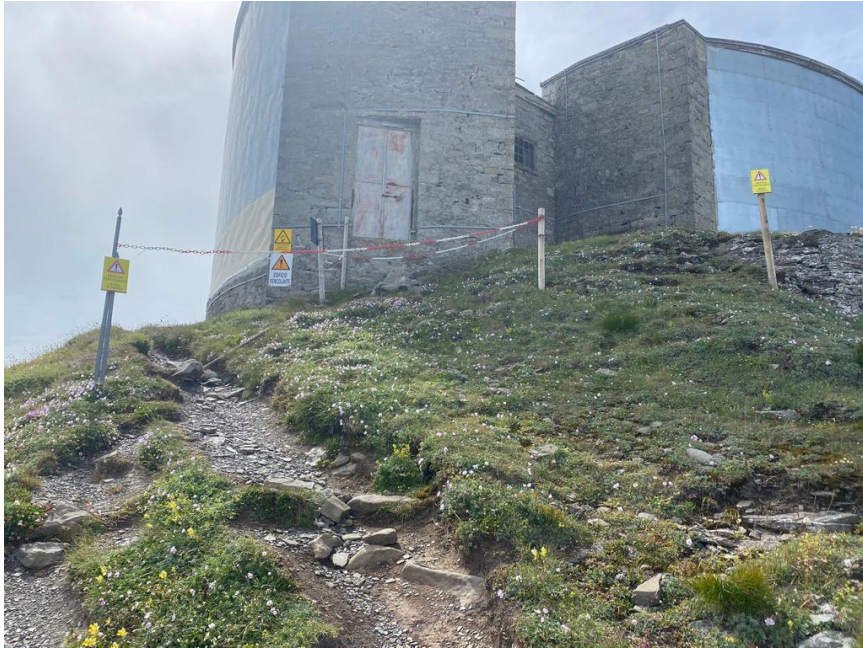
Fig. 3: foto da Ovest, dal basso, delle strutture Venda a sinistra e Settepani a destra; si notino la cartellonistica di avvertimento per rischio crollo e la recinzione di avvertimento con catena in plastica bianco-rossa per avvertire gli escursionisti sul sentiero sterrato, a sinistra nella foto.
